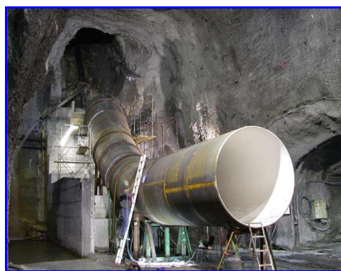
Impianto idroelettrico di Premadio II Condotta forzata (Alpi)
